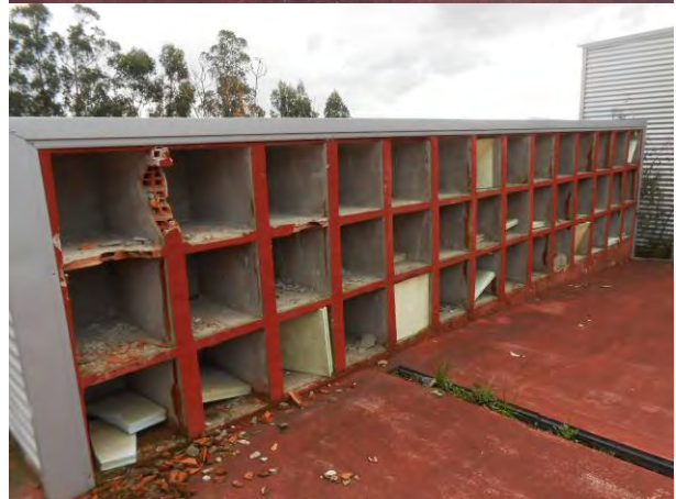
Módulo de columbarios en la explanada de edificios
